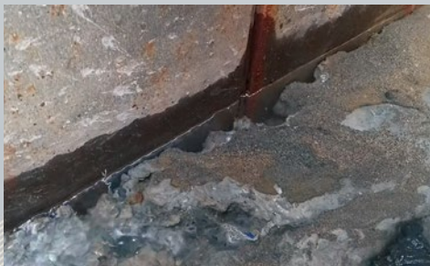
圖25 封底混凝土遭水流冲刷破壞情形
