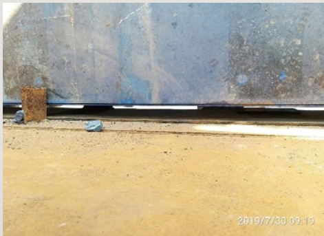
圖24 鋼箱底板與側板交接處間隙
