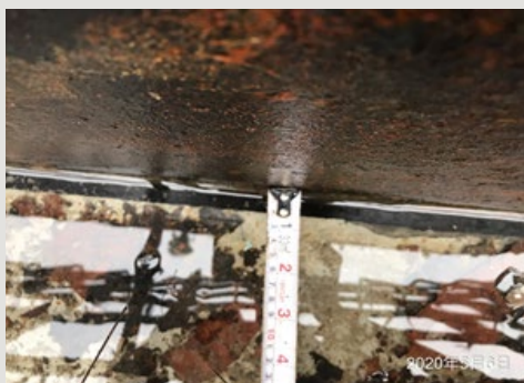
圖28 側模箱體勁度不足產生縫隙
