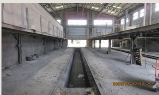
圖17 傳統設備／噴漆間作業之配套附屬設備，較為簡陋、無阻隔。
