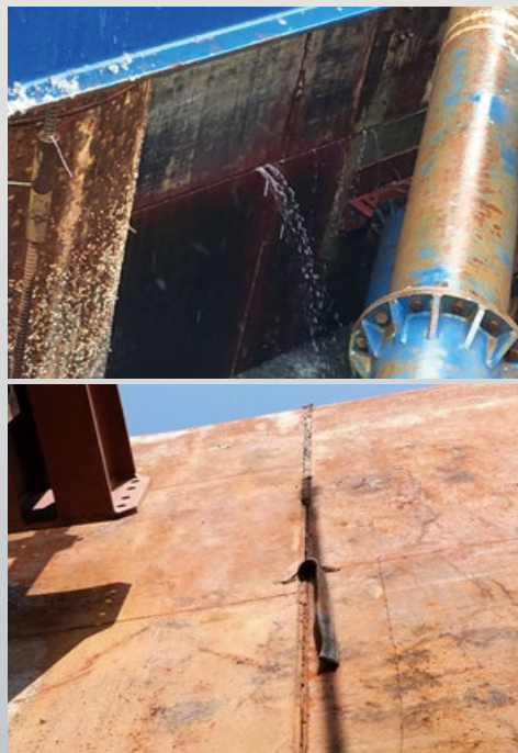
圖27 鋼箱側板變形產生間隙
