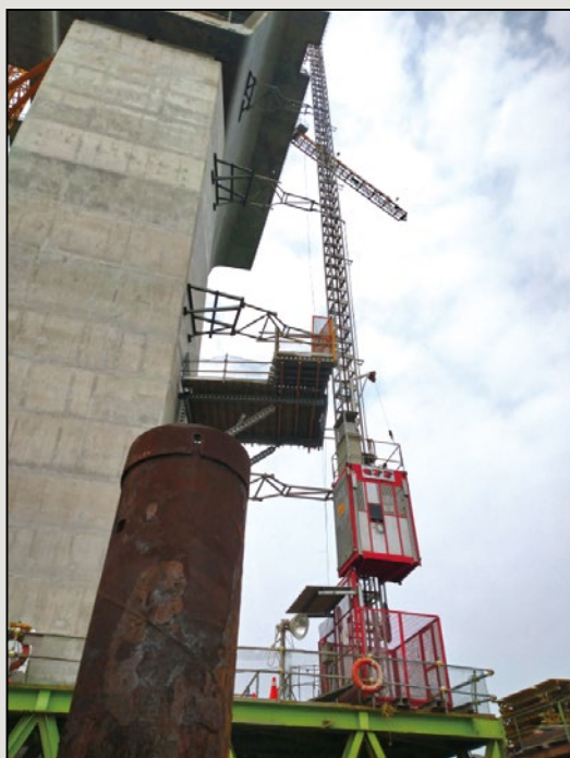
圖26 主橋橋塔載人升降設備
