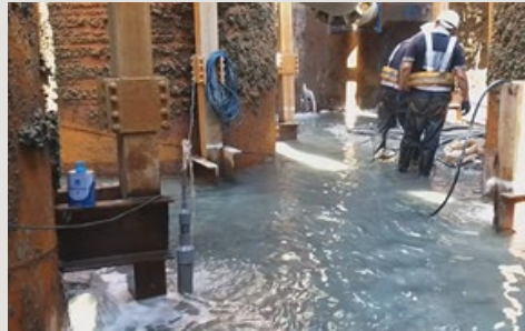
圖26 止漏封板間隙致混凝土漏漿滲水
