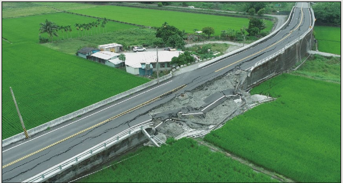
圖7 高寮大橋無人機空拍影像：路堤段擋土牆損毀
