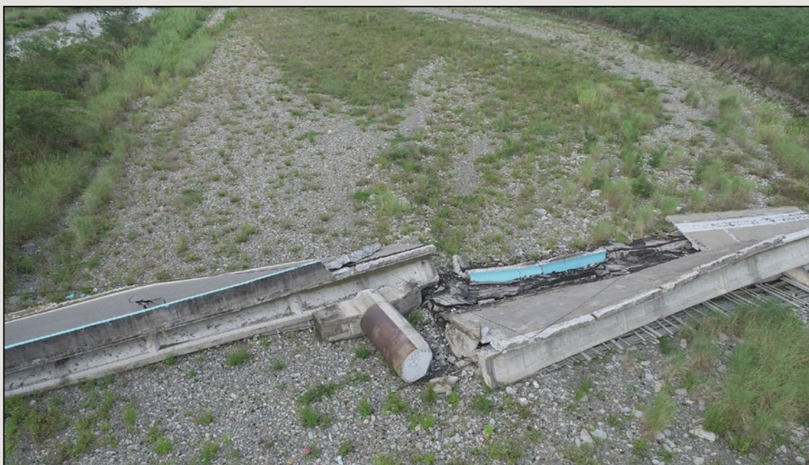
圖21 崙天大橋無人機空拍影像：橋墩斷裂、橋面板翻落
