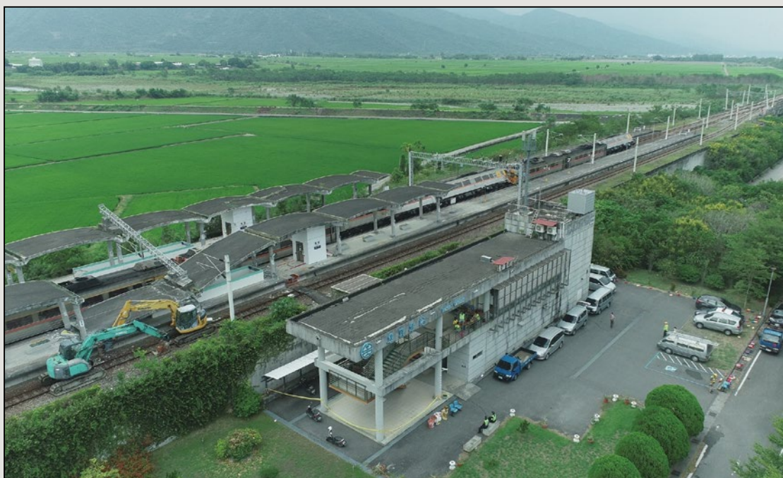
圖15 臺鐵東里車站無人機空拍影像：遮雨棚倒塌
