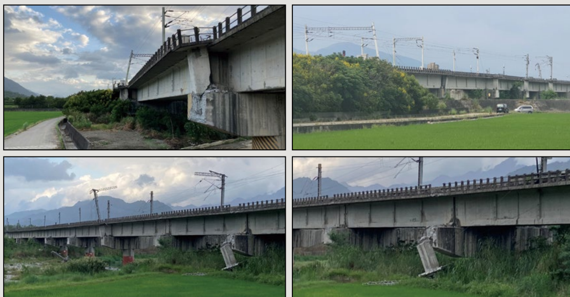
圖19 臺鐵新秀姑巒溪橋地面拍攝影像：鋼筋混凝土基礎墩柱斷裂
