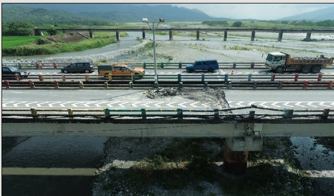
圖9 玉里大橋無人機空拍影像：伸縮縫受損
