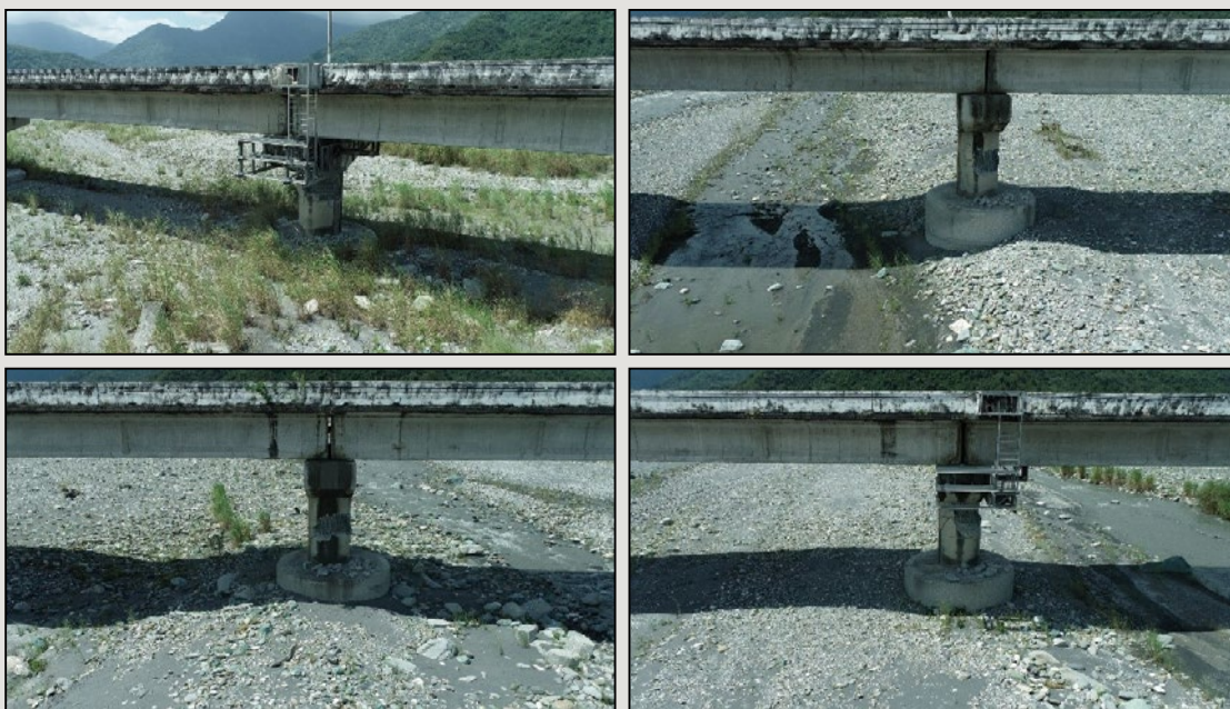
圖14 玉長大橋無人機空拍影像：橋墩受損局部近拍
