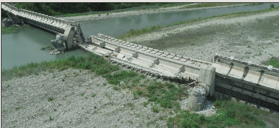
圖6 高寮大橋無人機空拍影像：橋墩斷裂、橋面板翻落局部近拍
