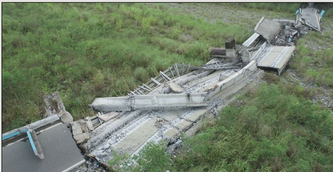
圖22 崙天大橋無人機空拍影像：橋面板翻落局部近拍
