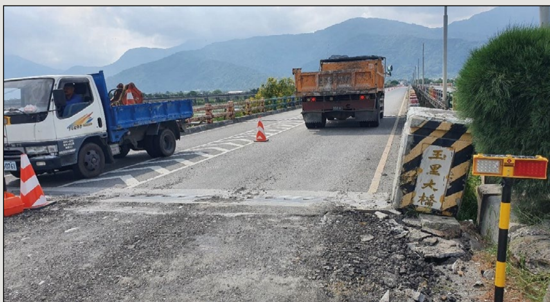
圖10 玉里大橋地面拍攝影像：橋頭高程落差
