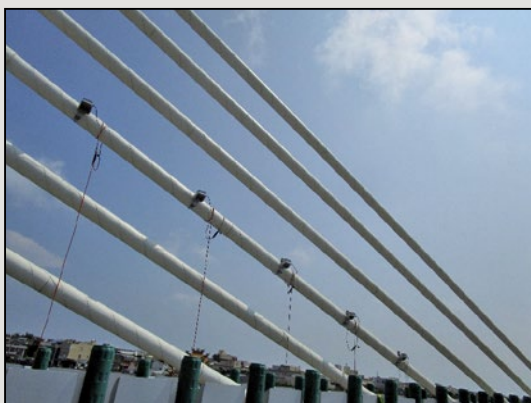
圖2 五顆感測計於鋼纜布設實景
