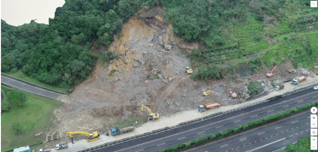
圖32 國道1號汐止交流道邊坡崩塌3D Mesh影像模型
