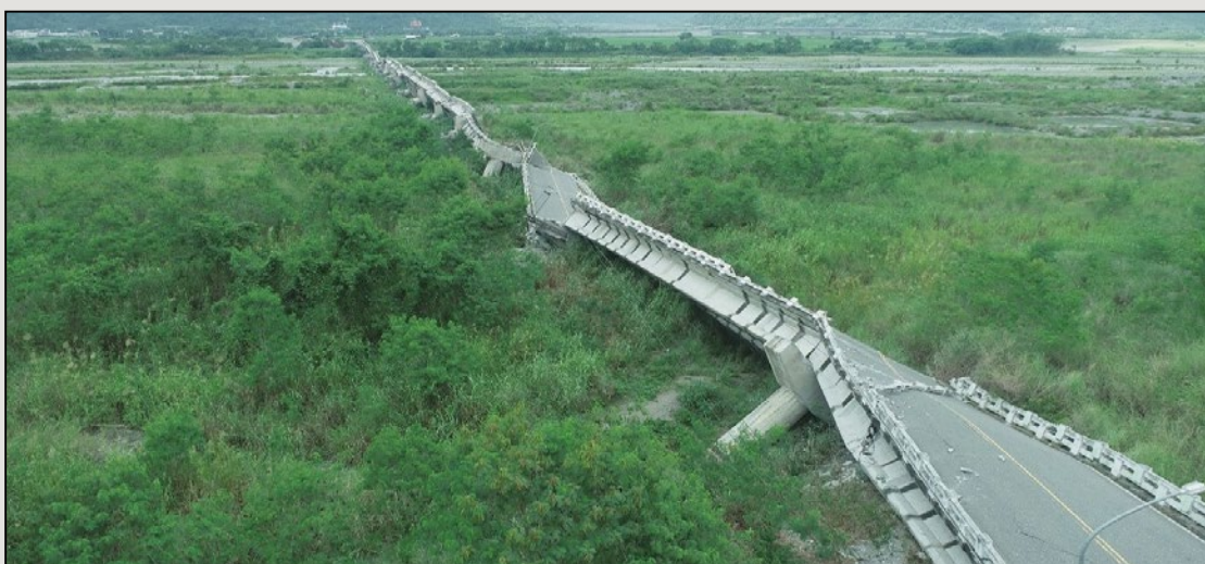
圖5 高寮大橋無人機空拍影像：橋墩斷裂、橋面板翻落
