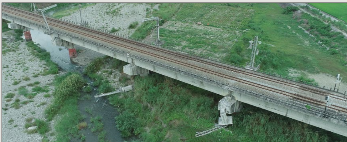
圖18 臺鐵新秀姑巒溪橋無人機空拍影像：架線柱倒塌
