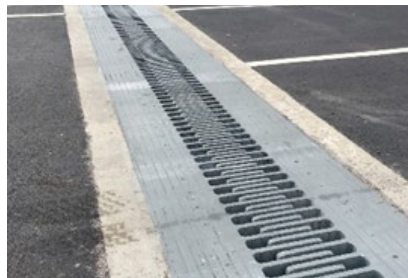
(f) 北外環道路伸縮縫錨固材[90]
