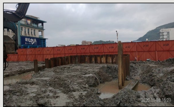
圖13 鋼板樁打設遭遇地下障礙物
