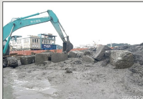
圖14 混凝土地下障礙物
