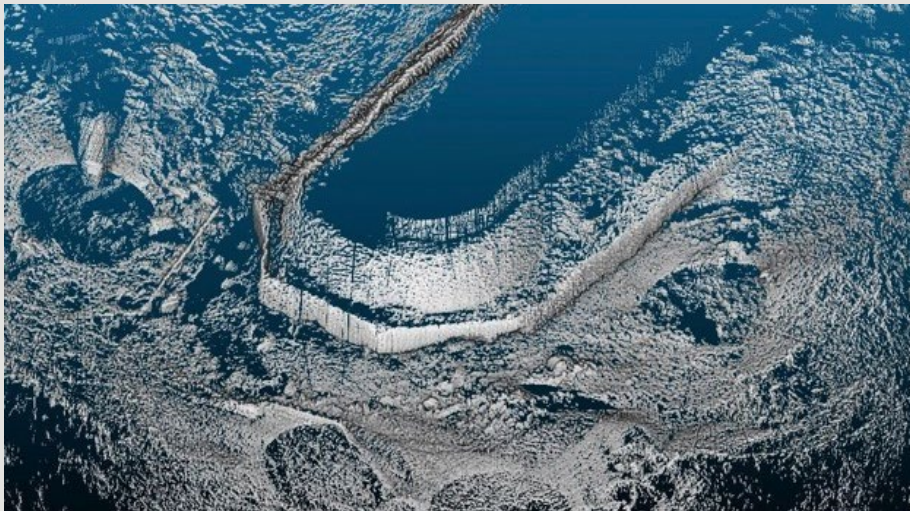
圖6 以多音束聲納掃描帶聲納掃描橋墩基礎弱化與混凝土劣化三維點雲圖[57]
