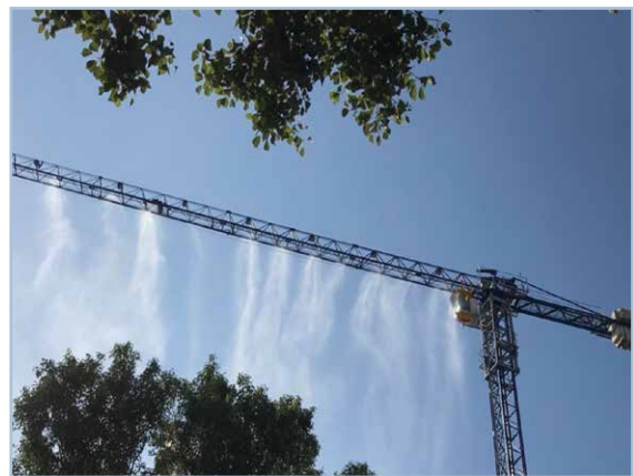
圖 18 塔吊設置噴淋系統
