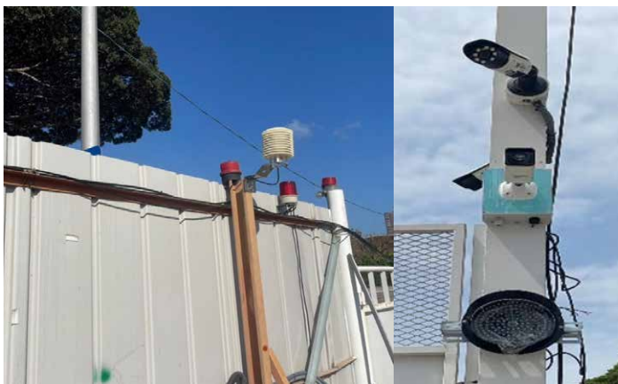
圖 26 環保科技化環境感測器及雲端監視設備
