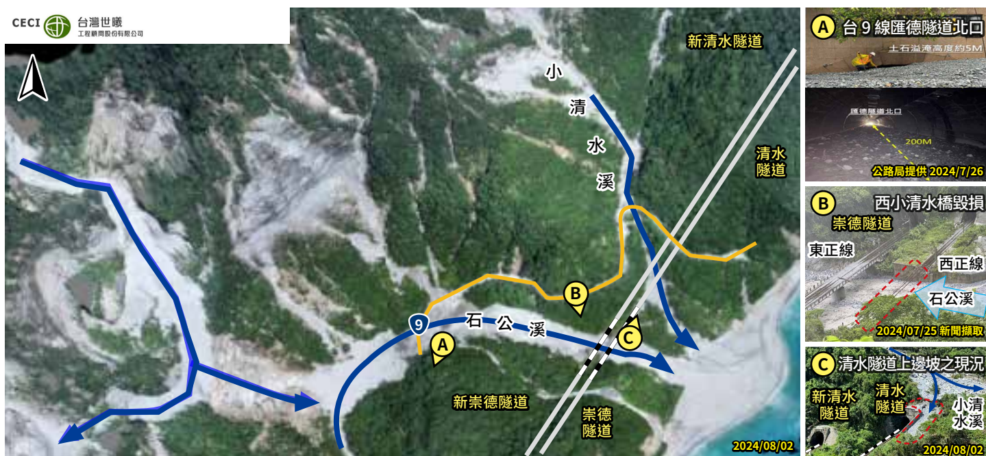
圖 12 災後 K53 路段受損情形
