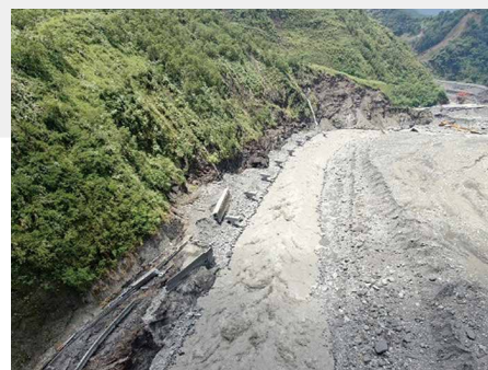
凱米颱風造成明霸克露橋橋面沖毀
