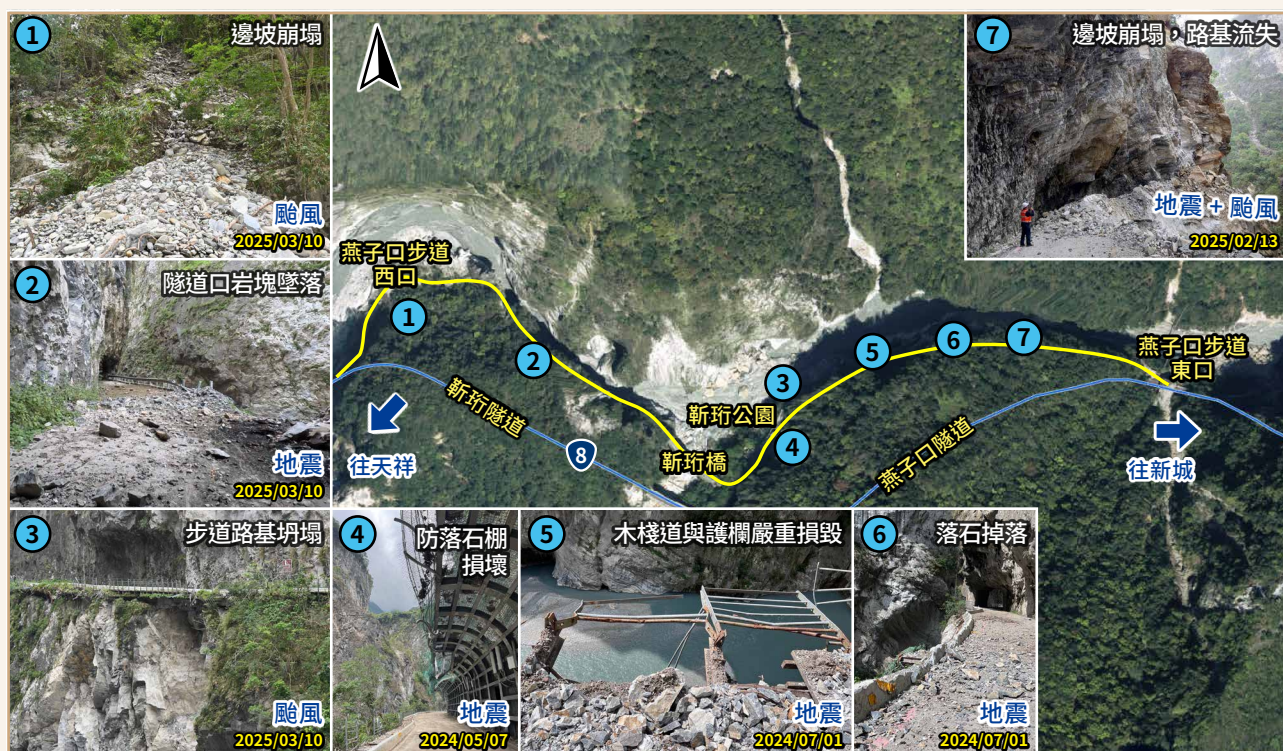
圖 7 燕子口步道遊憩區災損
