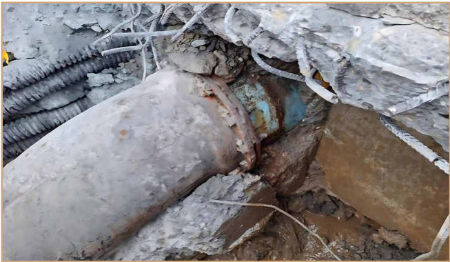
圖 14 中正橋 Ø600DI 過橋管脫接漏水 (資料來源：自來水公司九區處)
