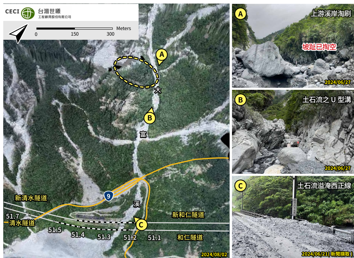
圖 10 災後 K51 路段受損情形
