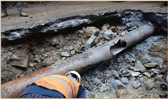
圖 13 富世原水管遭落石砸毀(資料來源：自來水公司九區處)
