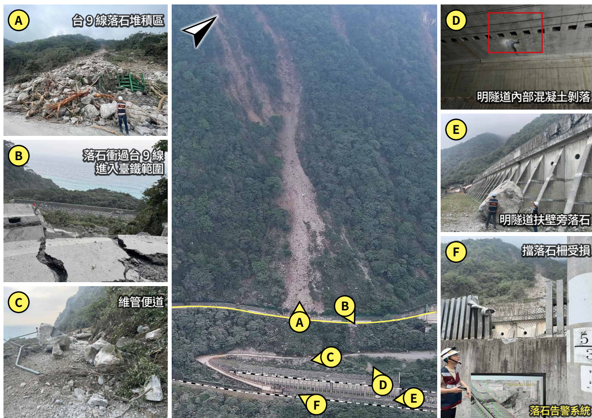
圖 5 地震後 K51 路段受損紀錄
