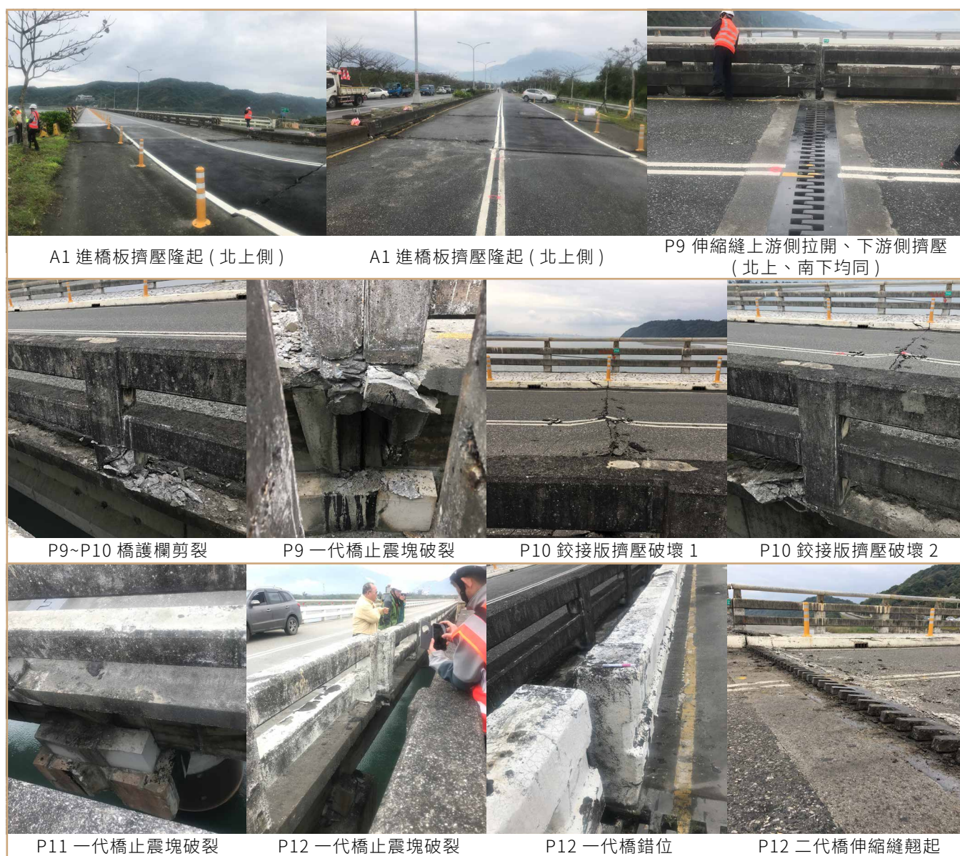
圖 5 花蓮大橋震後災損照片
