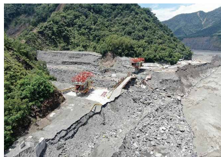
凱米颱風使新建中之中期橋梁，橋墩外側高培厚填土遭荖濃溪主流深槽區河水冲刷破壞
