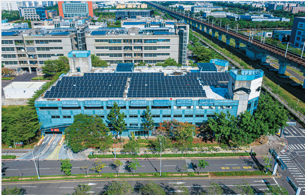
立體停車場屋頂的太陽光電，善用既有建築屋頂空間發電。南科推動綠電使用，未來風電也將納入供應鏈（照片由南科管理局提供）
